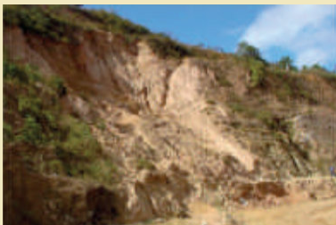
1. Talude com instabilidade geral com escorregamentos e movimentação de massa, apresentando erosões.
