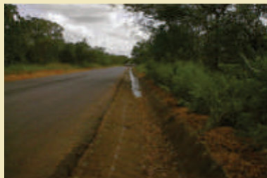
5. Canaleta de drenagem superficial, revestida com Tela Sintemax® 400TF, adjacente à rodovia.
