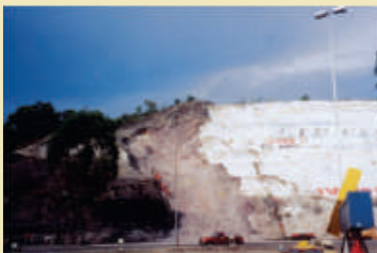
1. Talude apresentando instabilidade geotécnica, com erosões generalizadas, escorregamentos e carreando grande volume de sedimentos.
