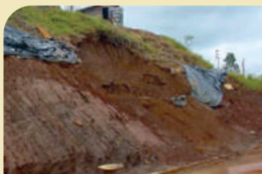
1. Vista geral do deslizamento do talude, causando erosão que será recuperada com as Técnicas de Bioengenharia.
