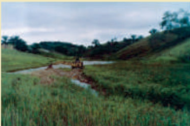
1. Curso d'água totalmente assoreado, iniciando o processo de recuperação, desassoreamento e proteção.
