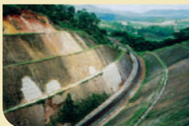
1. Taludes de corte adjacentes à ferrovia, com escorregamentos e focos erosivos generalizados, necessitando de intervenção imediata.
