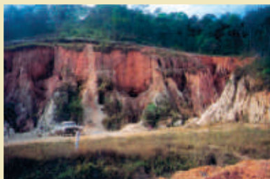
1. Área erodida de difícil recuperação, a ser tratada com uso de Técnicas de Bioengenharia.
